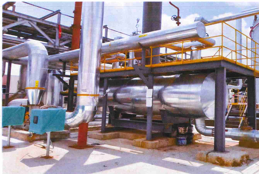
油罐区洗油喷淋塔系统
