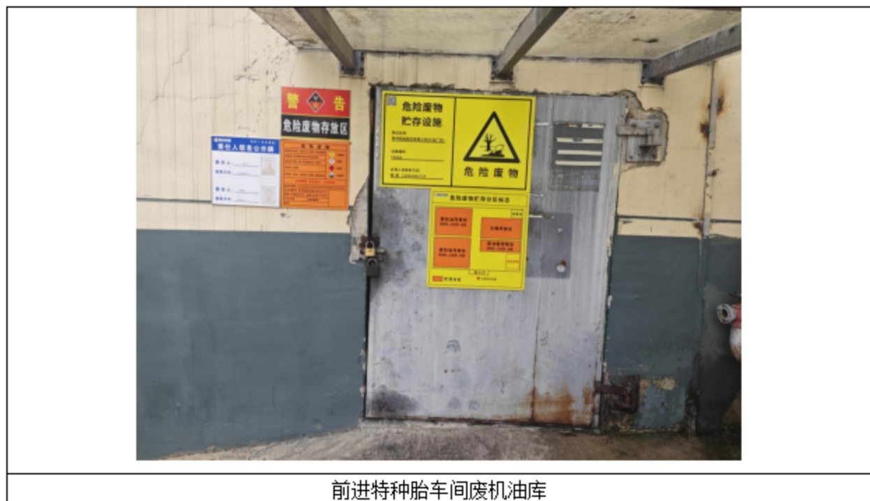
图 5.5-2 危险废物暂存间现状
