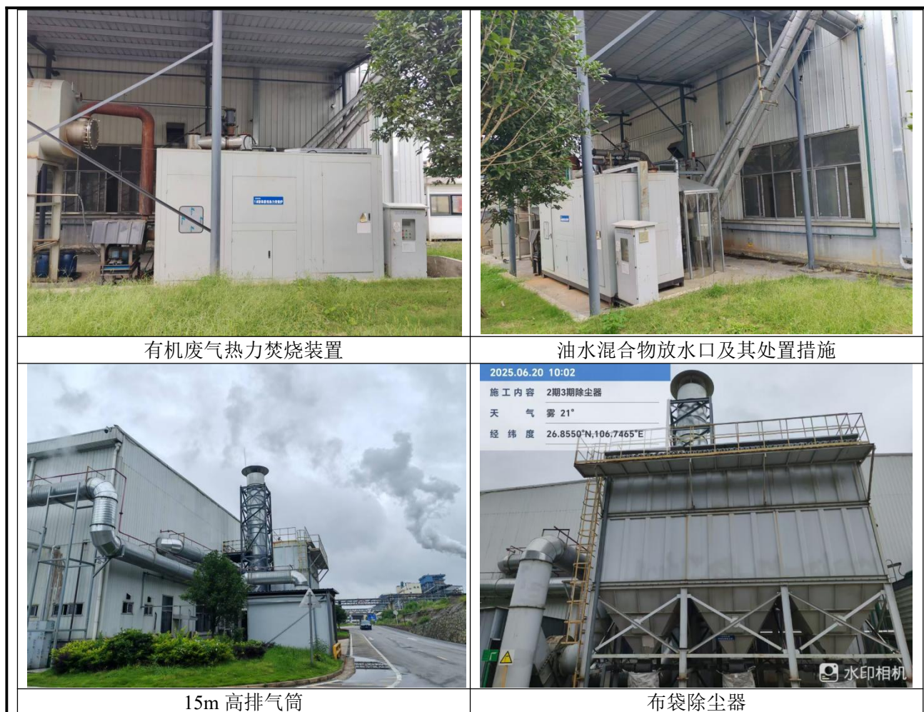
图 3-2 废气处理措施
