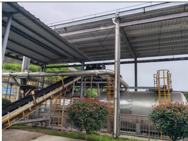
油罐区呼吸废气收集管道
